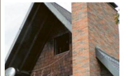
Am kaputten Giebfenster sieht man leichte Spuren des Brands. Foto: Arloth
